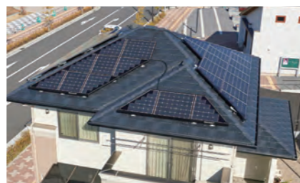
■ 4.97kWシステム (奈良県)
