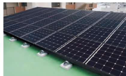
■ 7.13kWシステム (沖縄県)
