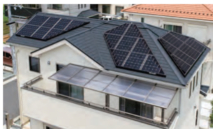
■ 2.98kWシステム (奈良県)
