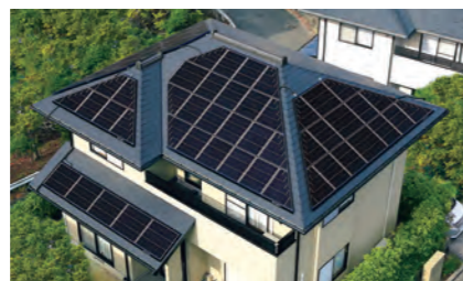
■ 9.45kWシステム (奈良県)
